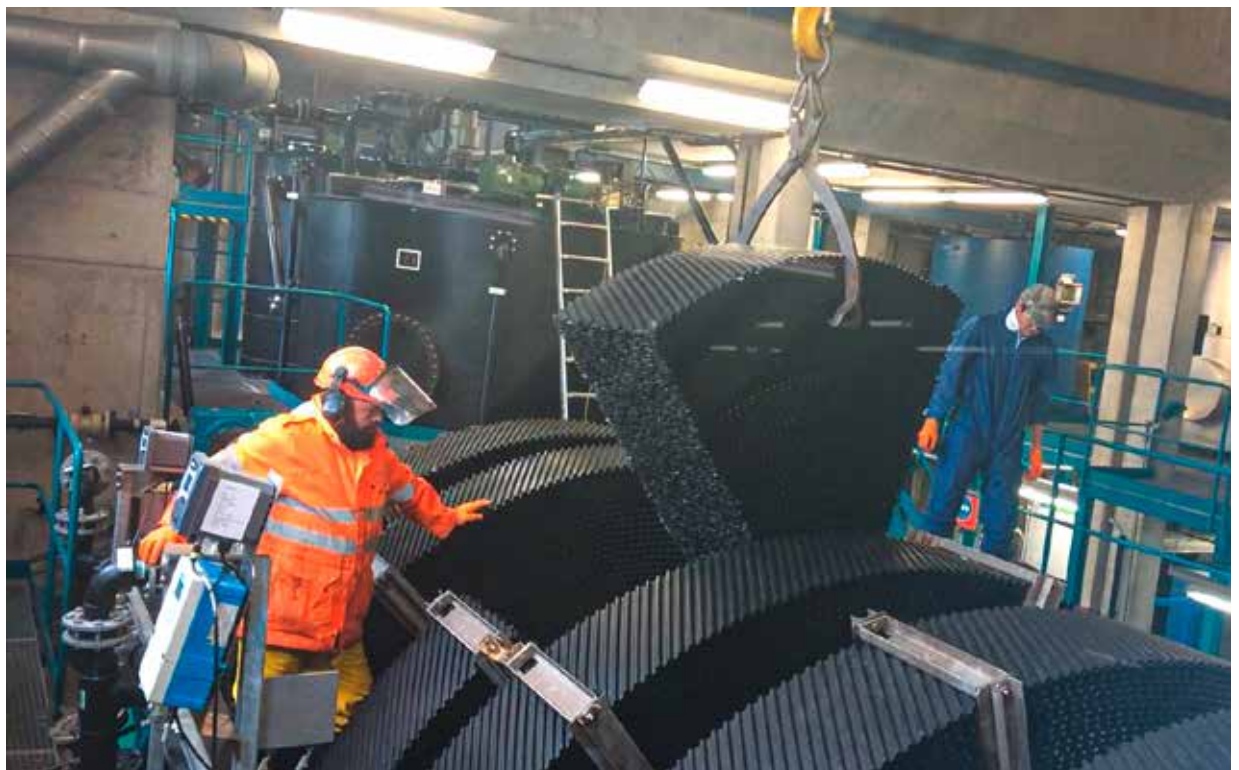
Abb. 3.3: Ausbau eines Wickelpakets TTK1 am 12. Mai 2020 durch die Firma Mecana AG, Reichenburg
