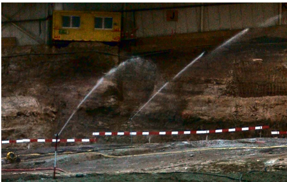
Abb. 4-5: Sprinkleranlagen im Westbereich in Betrieb, Blick gegen Westwand (Aufnahme A. Brändli)
