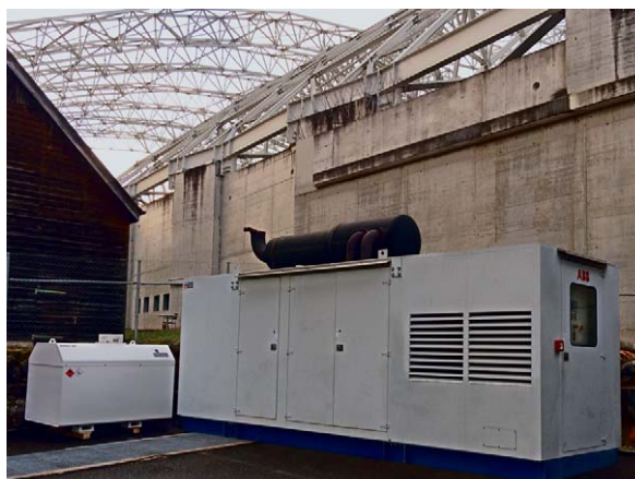
Abb. 3-4: Das Notstromaggregat am neuen Standort neben der SWALBA
