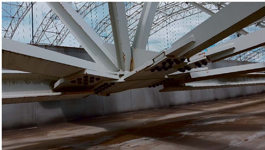
Abb. 5.3 : Die Stahlkonstruktion und die Gebäudehülle befinden sich nach wie vor in gutem Zustand
