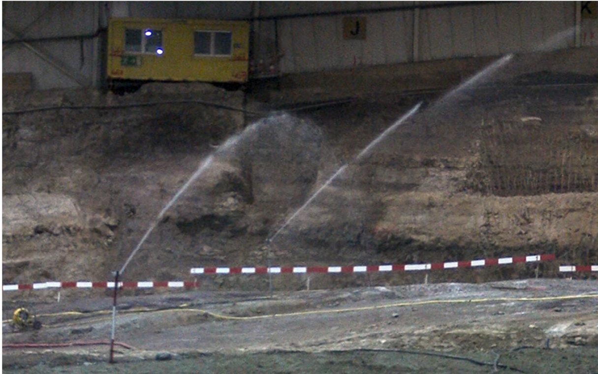
Abb. 7: Sprinkleranlagen im Westbereich in Betrieb, Blick gegen Westwand (Aufnahme A. Brändli)
