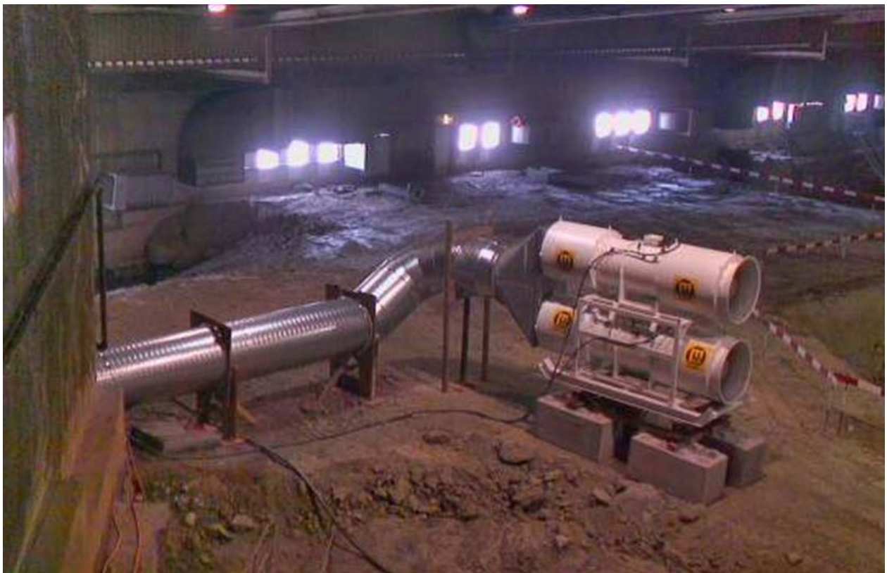
Abb. 6: Temporäre Abluftventilatoren, in Betrieb bis Ende Auffüllphase
