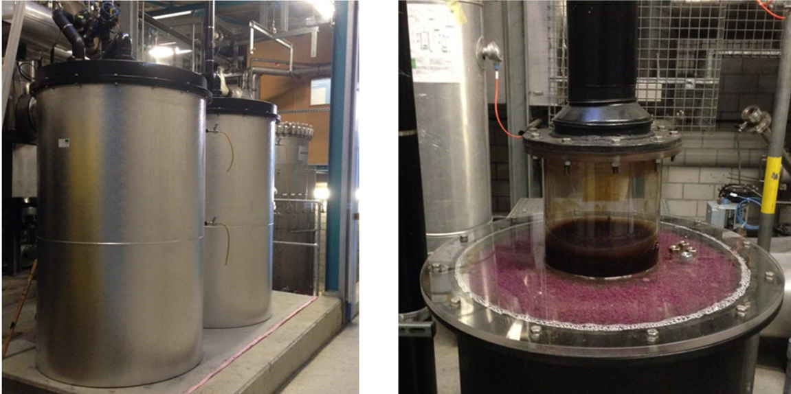
Abb. 9: Zwei Aktivkohlefilter für Abluft (links), Schauglas zur Beobachtung der Sättigung Oxidationsfilter (rechts)
