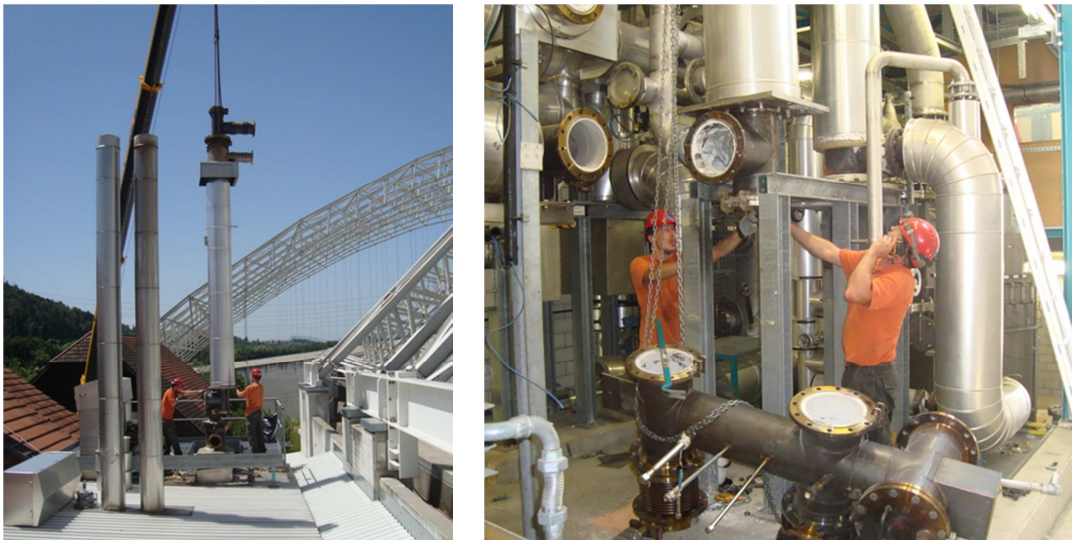
Abb. 10: Demontage der Wärmetauscher Ofenlinie 1 über Dach (links), Abbau der Stahlleitung und der nicht mehr benötigten Rauchgasklappen (rechts)
