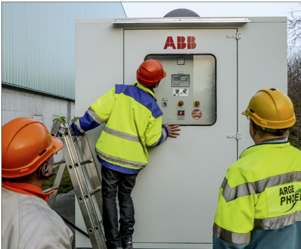
Abb. 5-5: Inbetriebnahme des Notstromgenerators während des Tests am 20. November 2013
