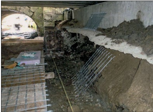
Abb. 5-18: Auskolkungen am Fundament der Mülibach Brücke.
