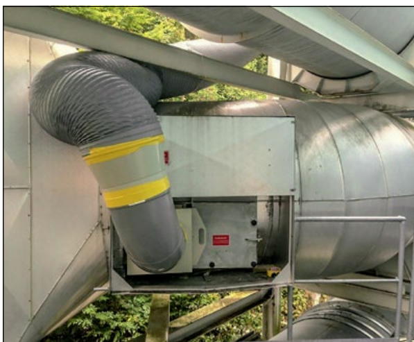
Abb. 4-17: Anschluss der Versuchsanlage vor dem Abluftkamin.
