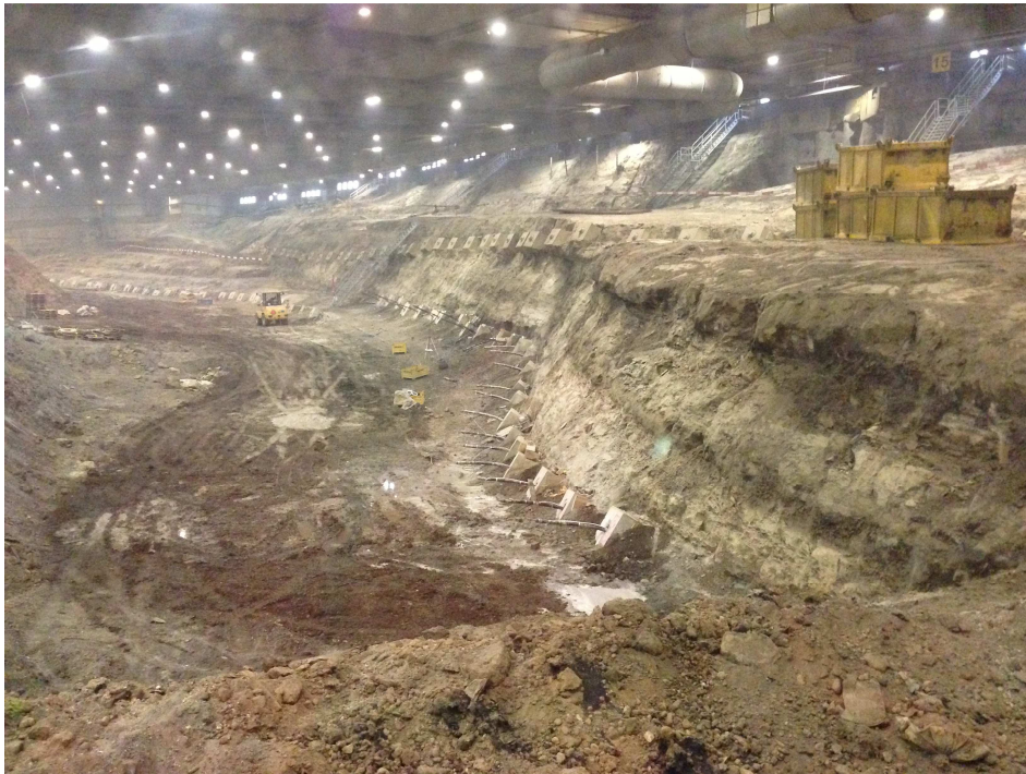
Abb. 2: Die Nordwand der ehemaligen Tongrube ist fast vollständig freigelegt. An der Basis sind bereits die Ankerköpfe der zweiten Ankerlage kurz vor der Fertigstellung.
