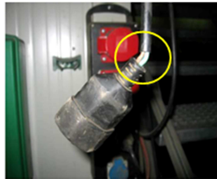
Abb. 7: sichtbare Leiterkabel am Stecker
