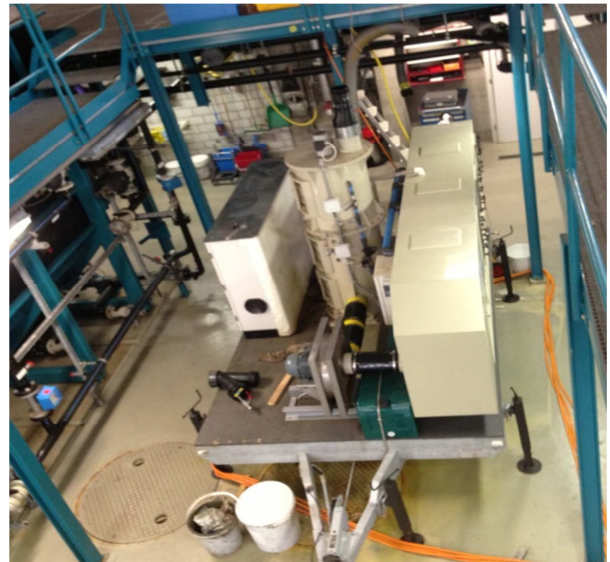
Abb. 15: Versuchsanlage Biofilter in der Biologiehalle SWALBA-Gebäude
