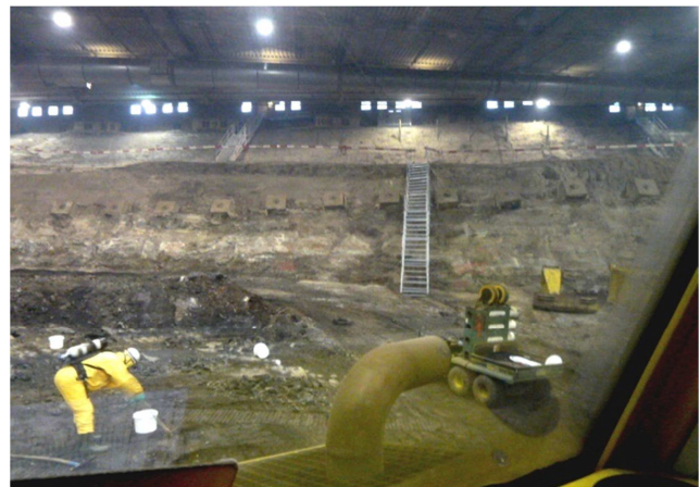
Abb. 6: Marcel Hotz bei der Probenahme am Asbesthotspot, im Hintergrund die neue Fluchttreppe
