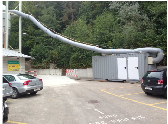
Abb. 11: Versuchsanlage für 6'000 m 3 /h auf dem Vorplatz der Lagerhalle
