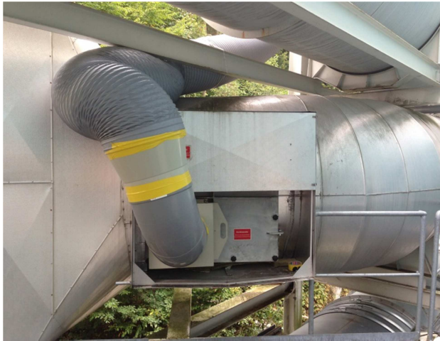
Abb. 10: Anschluss der Versuchsanlage vor dem Abluftkamin
