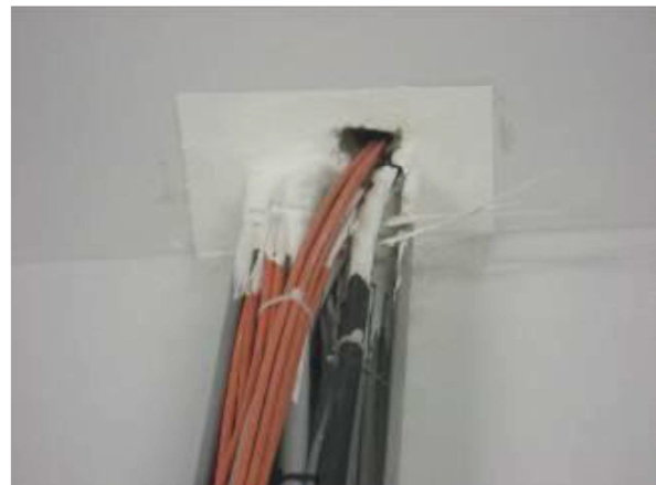
Abb. 7: Brandabschottungen müssen intakt sein
