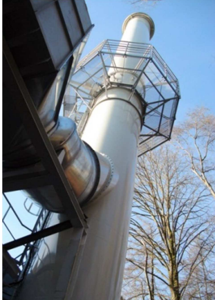
Abb. 11: Abluftkamin mit Vorrichtung zur Geruchskontrolle
