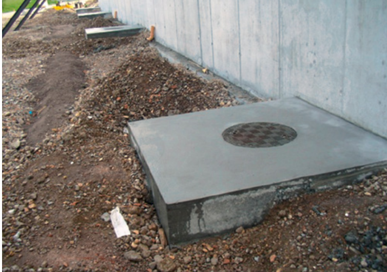
Abb. 4-13: Neu erstellte Schutzschächte der nördlichen Interventionsbrunnen in der neuen Aufschüttung, Blick in südliche Richtung.
