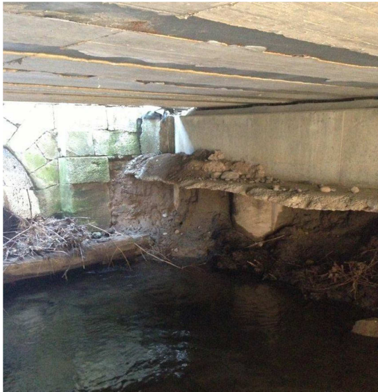
Abb.5: Auskolkungen (rechts) am Fundament der Mülibach Brücke
