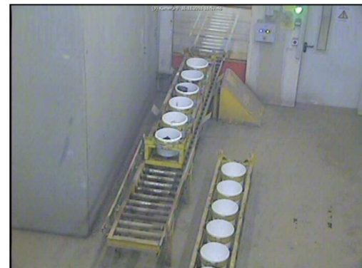
Schleuse für Probenbehälter vom Schwarz- in den Weissbereich
