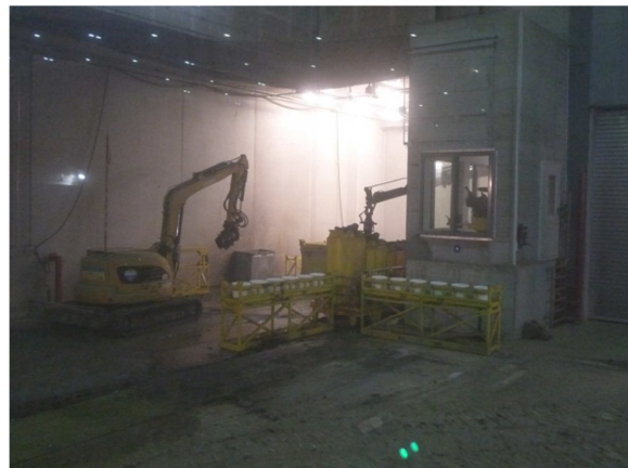
Probenahmebereich, Blick aus der Rückbauhalle, rechts Probenahmekanzel
