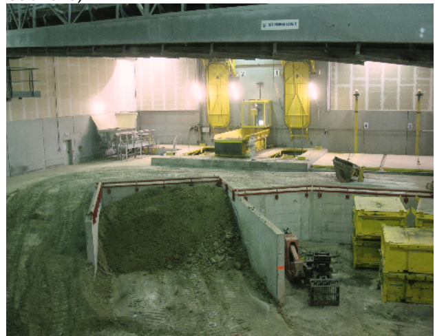
Die Abfüllstation für Transportcontainer in der Manipulationshalle
