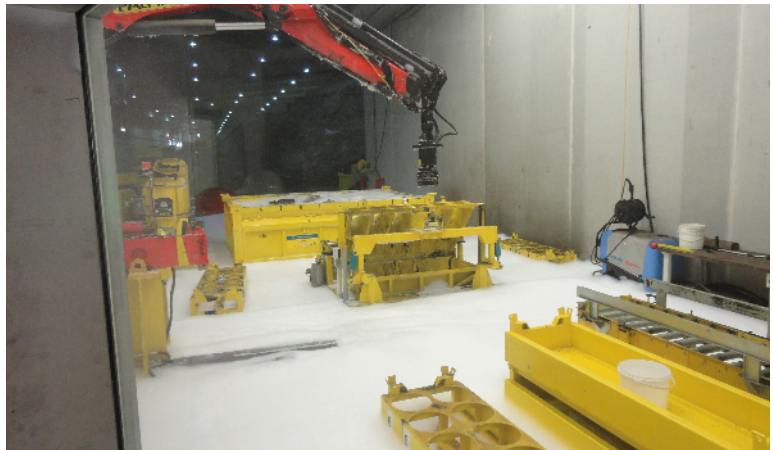
Bei der Auslösung der Sprinkleranlage wurde der Probenahme-Arbeitsbereich innerhalb von Minuten mit Löschschaum bedeckt
