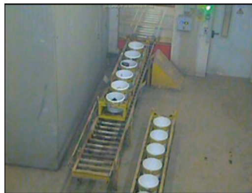
Abb. 5-19: Förderband mit Schleuse für Probeneimertransport in den Weissbereich
