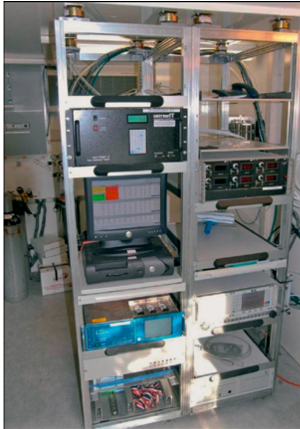
Abb. 4-6: Geräterack in der Messstation LIM-Ost (linke Hälfte von oben nach unten: Verdünnungseinheit für Kalibriergase, Gasprobensammler, Unterbrechungsfreie Stromversorgung; rechte Hälfte von oben nach unten: Steuergerät des Feinstaubmessgeräts, Messrechner, Gaschromatograph, Meteorologie-Haupteinheit, Wandlereinheit der Datenerfassung)
