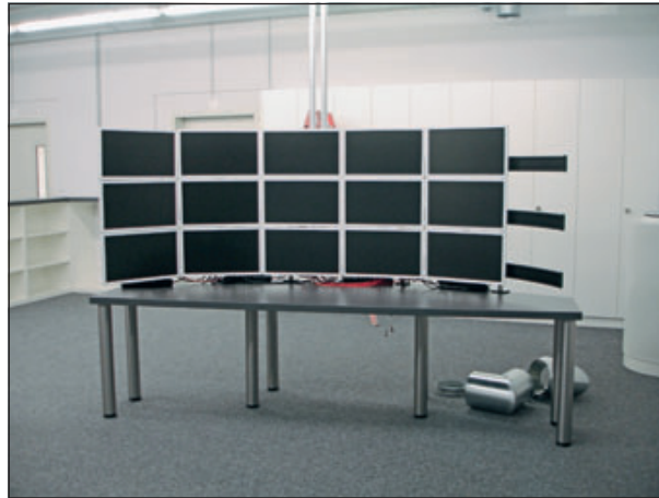
Abb. 5-13: Überwachungsmonitore der Leitwarte
