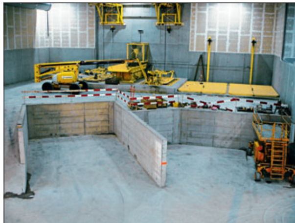
Abb. 5-11: Abfüllanlage für Container im Schwarzbereich
