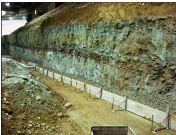
Abb. 5-16: Nördliche Baugrubenwand im Molassefels mit Wasseraustritten und Drainage an der Basis
