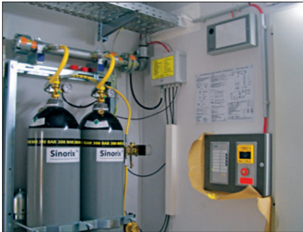
Abb. 5-6: Stickstofflöschanlage für Serverraum
