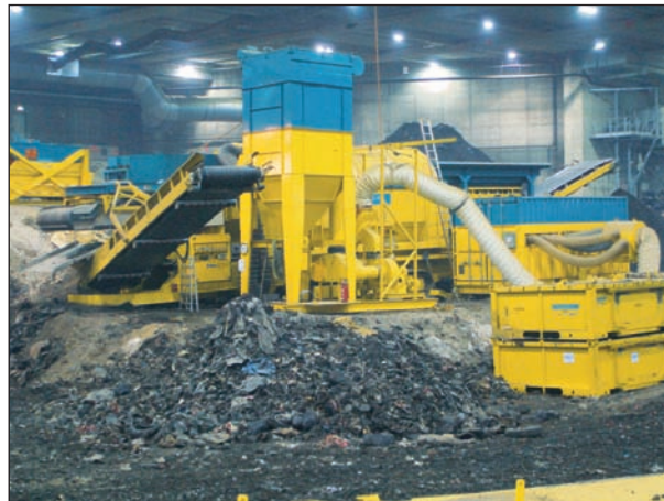
Abb. 5-4: Siebanlage zur Abtrennung der Grobfraction
