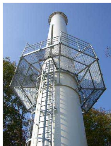
Abluftkamin mit Messplattform
