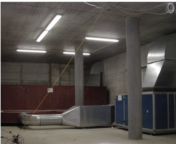
Lüftung des Stollens an neuem Standort
