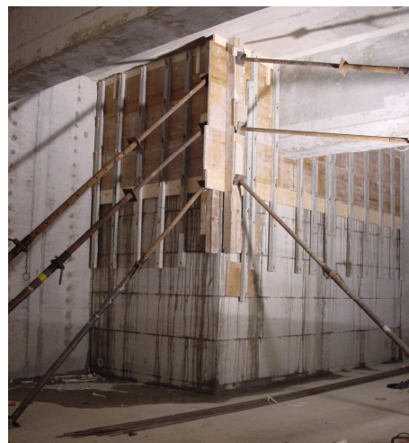
Brauchwasser-Becken (26 m 3 Inhalt)
